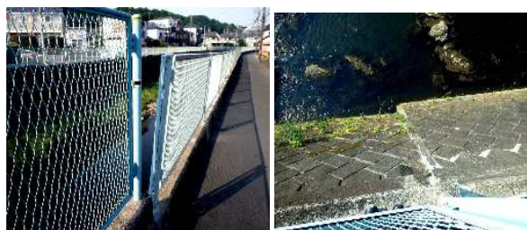
変状による護岸施設の見直し
