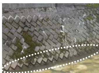
護岸の変状(ブロック隙間の拡大)
