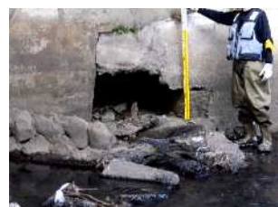
護岸背面部の空洞
