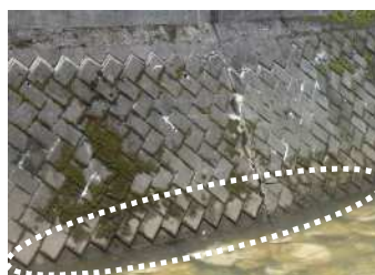
護岸の変状(ブロック隙間の拡大)
