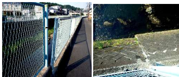
変状による護岸の目違い
