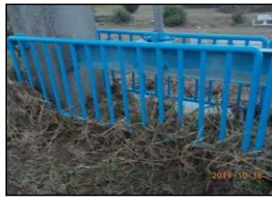
写真: 扉体上部状況 (台風後)
