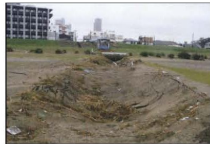
写真: 排水樋管周辺状況 (台風後)
