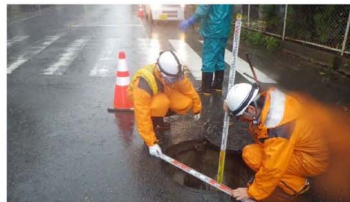
マンホール部 水位計測
