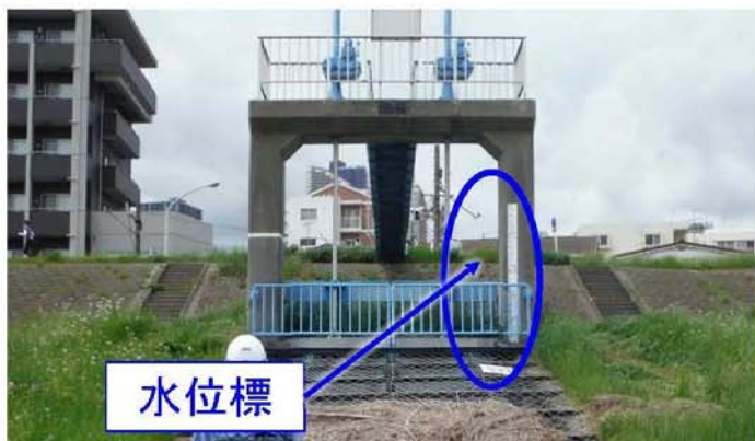
排水樋管部水位標
