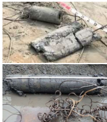
【記録に無い既製コンクリート杭】
