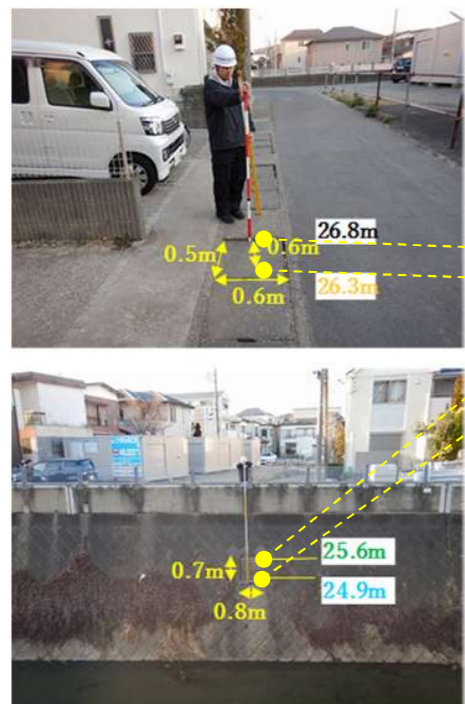
【吐き口部状況写真】
