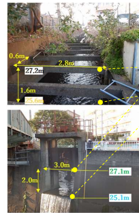
【吐き口部状況写真】
