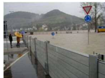
防水壁（設置事例）
