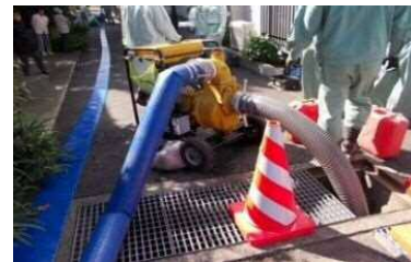
移動式ポンプ機（設置事例）
