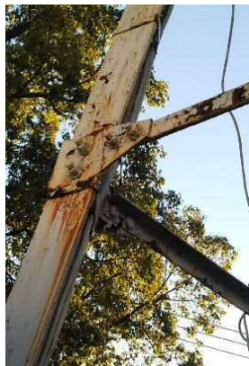
劣化・老朽化の状況
