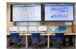
④⑨ 監視制御設備
