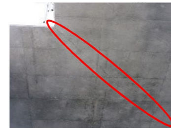
頂版のひび割れ状況
