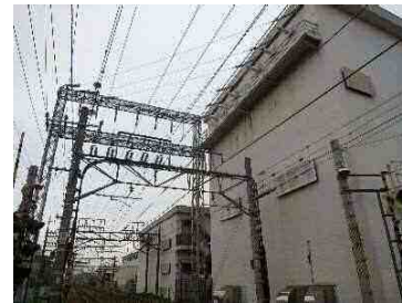
ガントリー・向河原変電所
