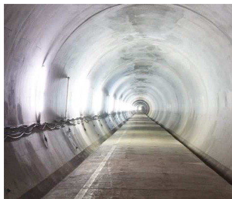
大師河原貯留管
