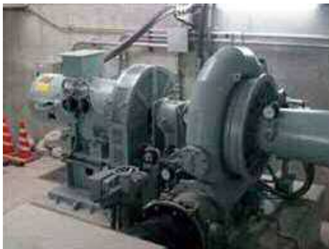
平間発電所小水力発電設備
