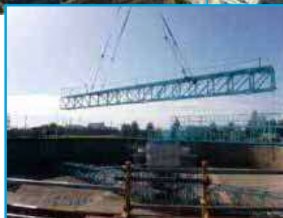
長沢浄水場 第1沈でん池 (工業用水道施設)
