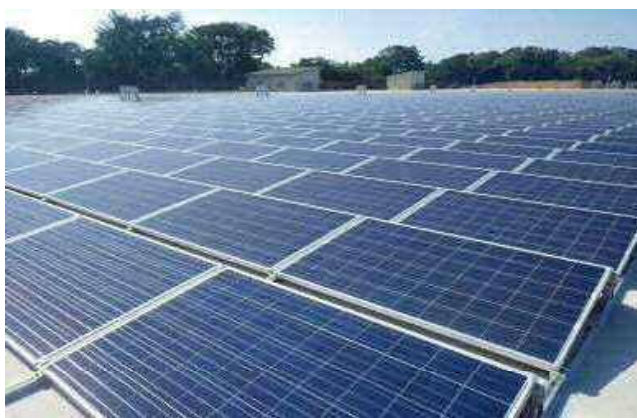
配水池上部を利用した太陽光発電
