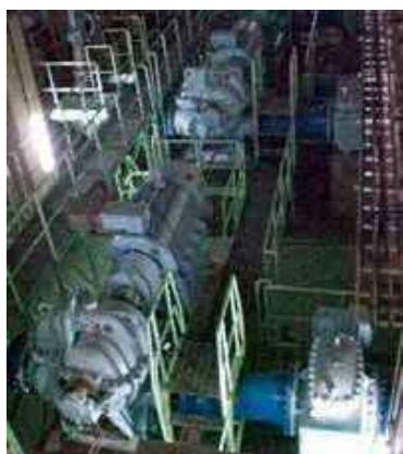
高効率な工水2号送水ポンプ
