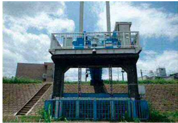
排水樋管ゲートの電動化(令和2(2020)年7月稼働)
