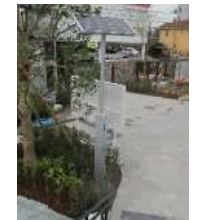
蓄電式太陽光発電照明灯
