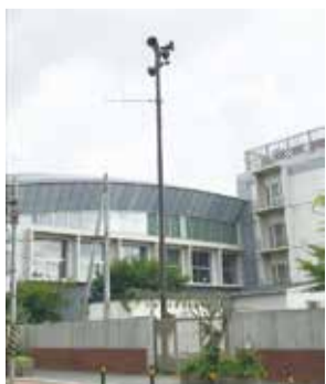
防災行政無線(屋外スピーカー)
