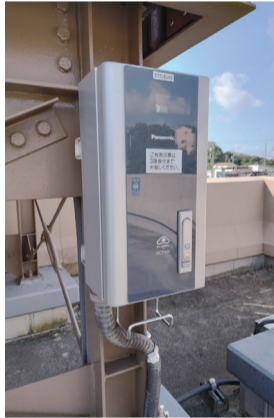
電気自動車充電設備
