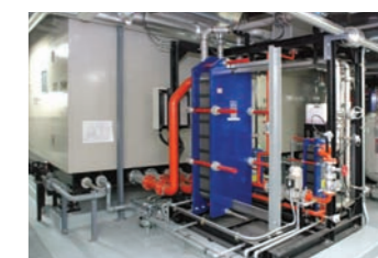
●コージェネレーションシステム
