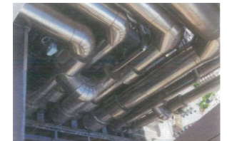
図 川崎病院配管の例 病院施設は、365日24時間稼働しており、通常施設より劣化の進行が速い可能性がある。
