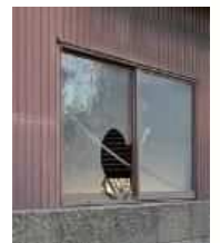
窓が割れた管理不全空家
