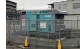
仮非常用発電機
