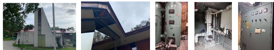
躯体の劣化が著しいエネルギー棟 渡り廊下軒裏の破損 耐用年数を超過した設備（ボイラー、消火設備、受変電設備）
