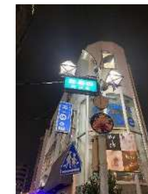
街路灯のLED化 (鹿島田商店会)
