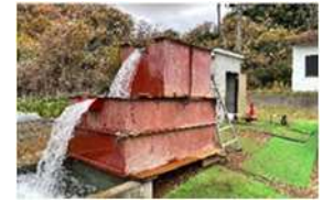
農業用施設等の長寿命化 【黒川海道灌漑施設】
