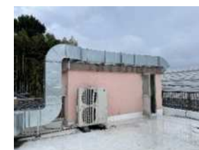
【環境改善支援助成の事例】 (株)阿部機械製作所 (ダクトルートの変更)
