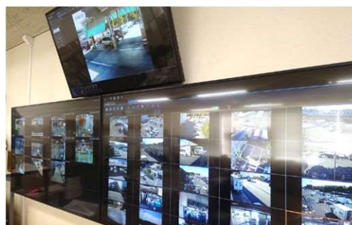
R2 に更新された監視カメラシステム
