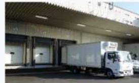
事業者が整備した低温管理設備
