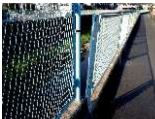
変状による護岸施設の目違い
