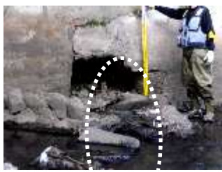
護岸背面部の空洞
