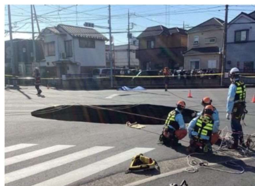
写真：道路陥没の事例
