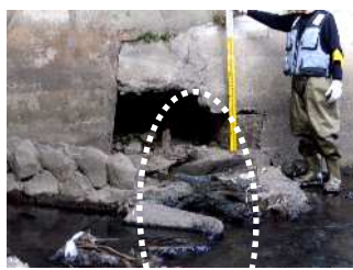
護岸背面部の空洞
