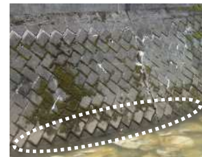
護岸の変状(ブロック隙間の拡大)
