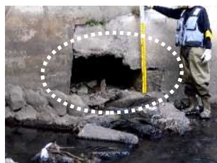
護岸背面部の空洞
