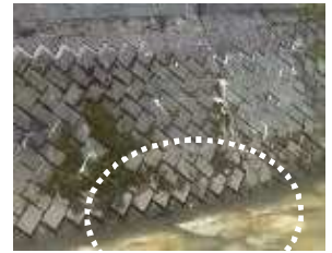
護岸の変状(ブロック隙間の拡大)
