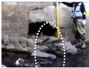
護岸背面部の空洞
