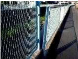
変状による護岸施設の目違い
