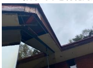
渡り廊下軒裏の破損
