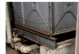
（受水槽の発錆、配管経年劣化）
