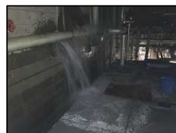
（プール循環配管の破断）
