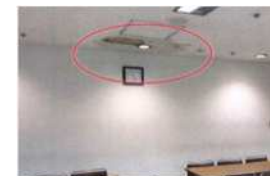
（漏水による会議室天井の欠落）
