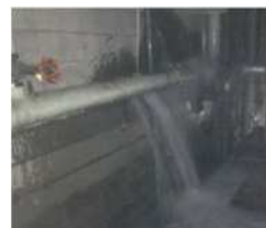
(R4：プール循環配管破断) ※R4.10～R5.6：プール休止
