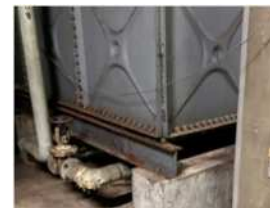
(受水槽) ※本体の発錆や配管の経年劣化
