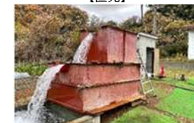
農業用施設等の長寿命化【黒川海道灌漑施設】
