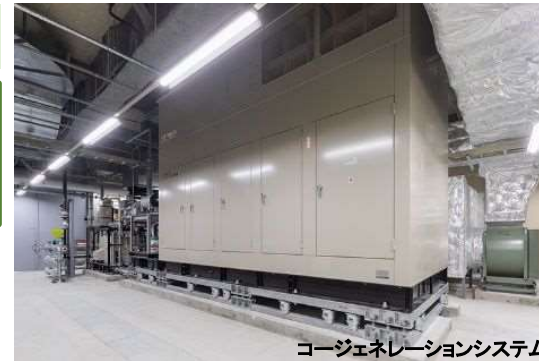
コージェネレーションシステム
