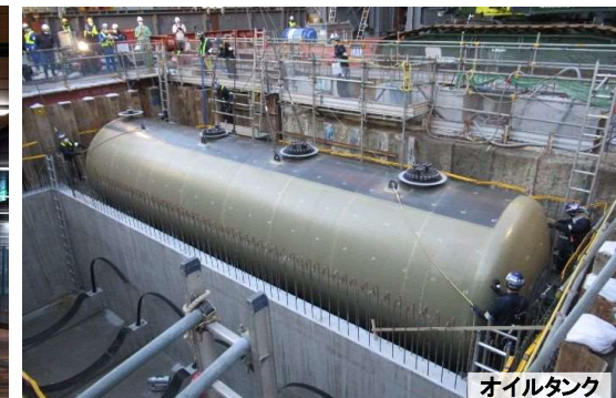
オイルタンク
