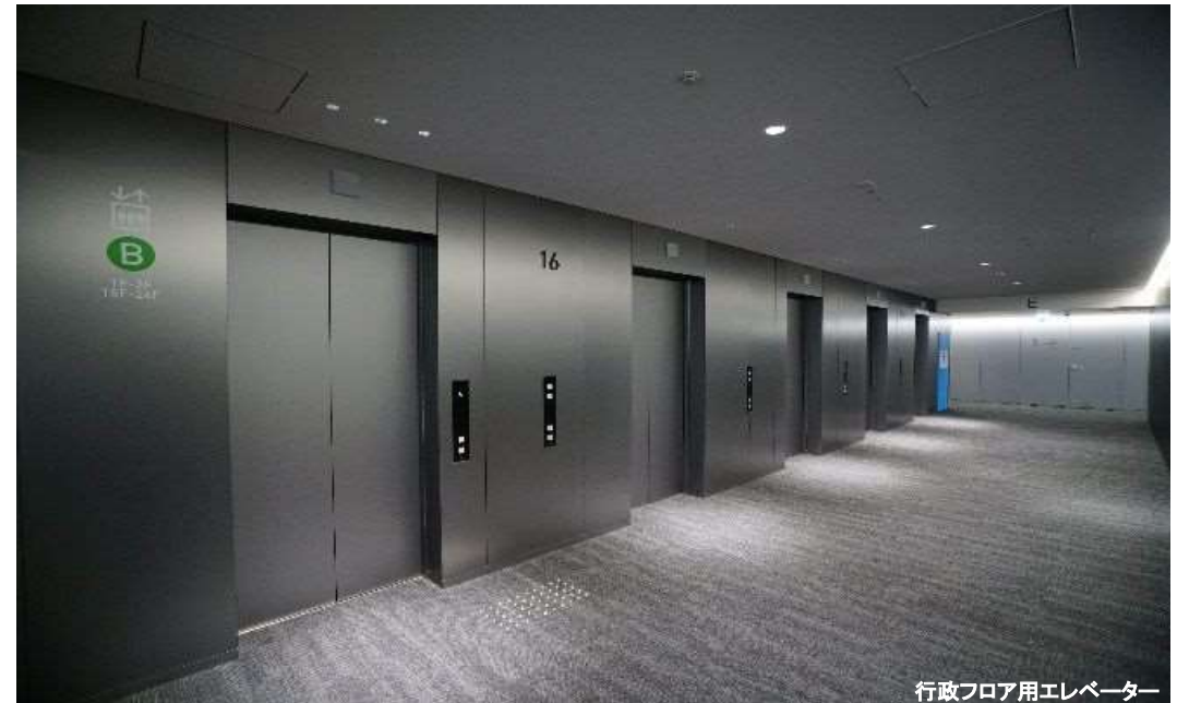
行政フロア用エレベーター
