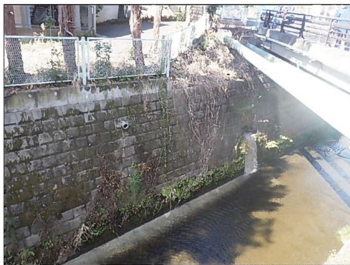
白濁水が五反田川への流出した状況 （誤接続箇所の下流）
