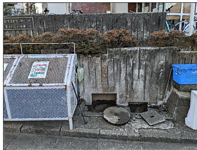
誤接続が確認された時点での最終ます （丸ふた：污水 角ふた：雨水）
