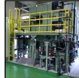
生物脱臭装置
