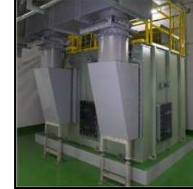
活性炭吸着塔
