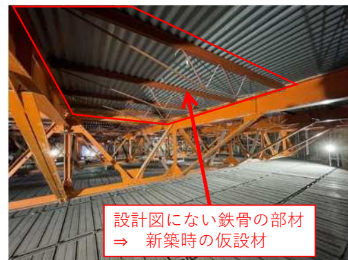
【②－3：大ホール屋根鉄骨梁の違い】
