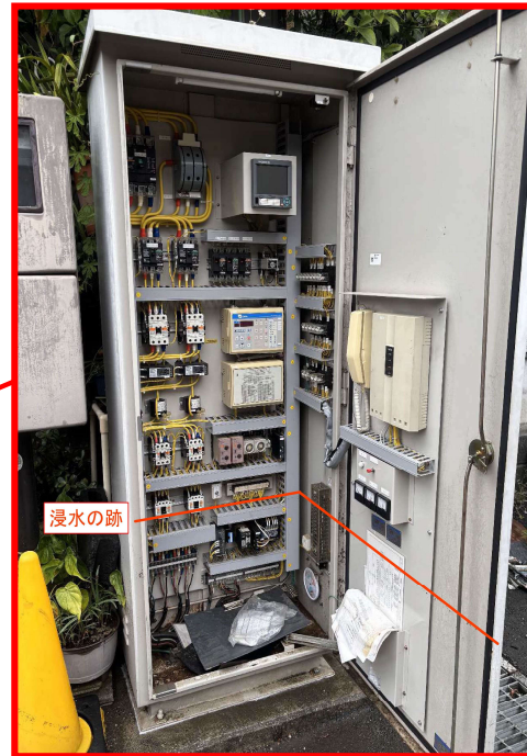
制御盤内部の状況
