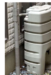
雨水貯留タンク
