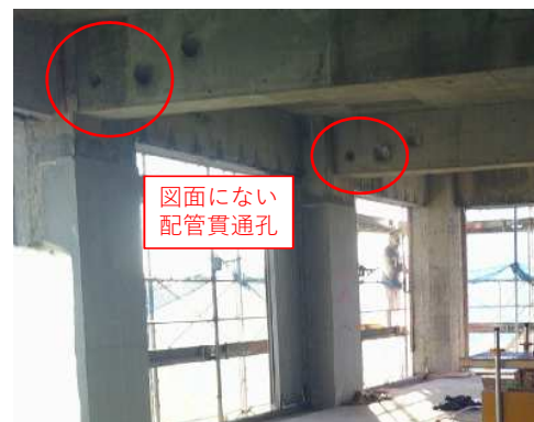
①-2 図面がない開口
