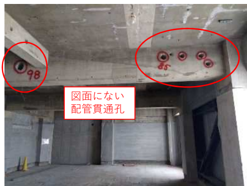
①-1 図面がない開口
