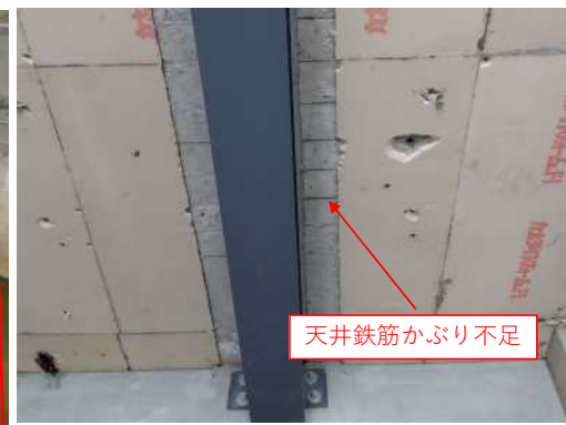
④5階天井スラブ下かぶり不足
