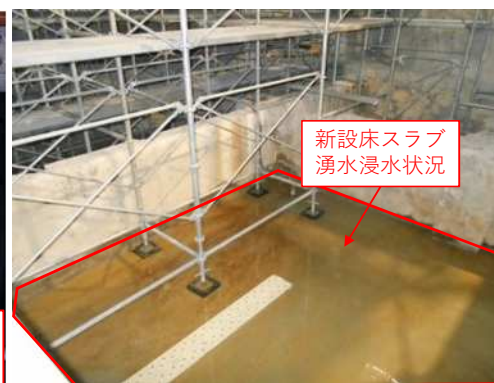
③大ホール新設床スラブに湧水
