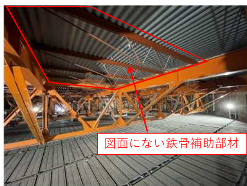
②-3 大ホール屋根鉄骨梁の違い
