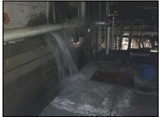
(R4: プール循環配管破断) ※R4.10～R5.5: プール休止
