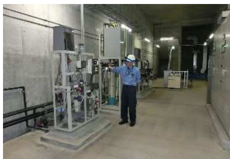
施設の点検(水質計器定期点検)
