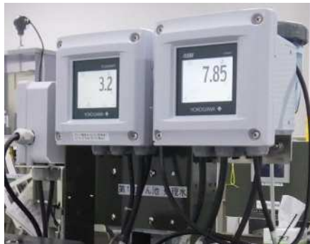
水質計器による常時監視
