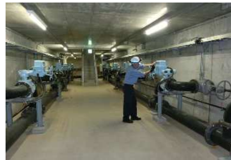
施設の点検(バルブ設備定期点検)
