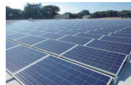
配水池上部の活用事例 (太陽光発電)
