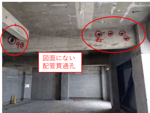
①-1 図面がない開口
