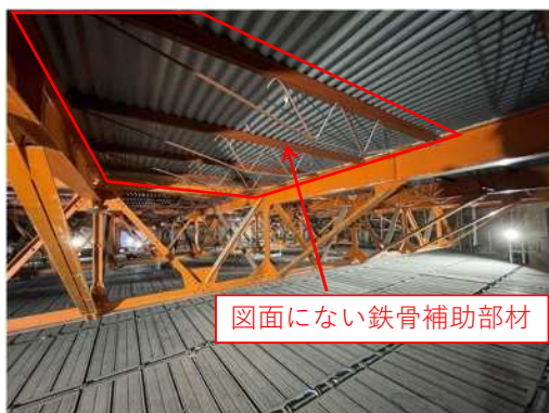
②-3 大ホール屋根鉄骨梁の違い
