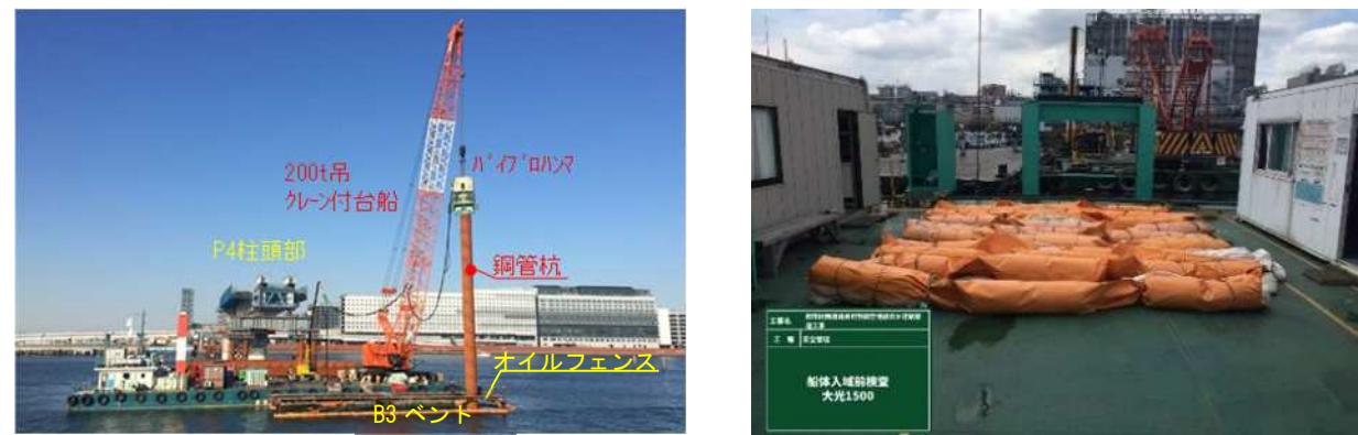
写真 2-48 オイルフェンス(左：展開状況、右：常備状況)
