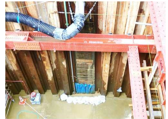
写真④ 鋼矢板隙間からの湧水状況
