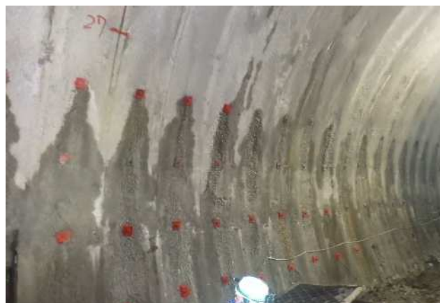
ロックボルト孔からの湧水状況
