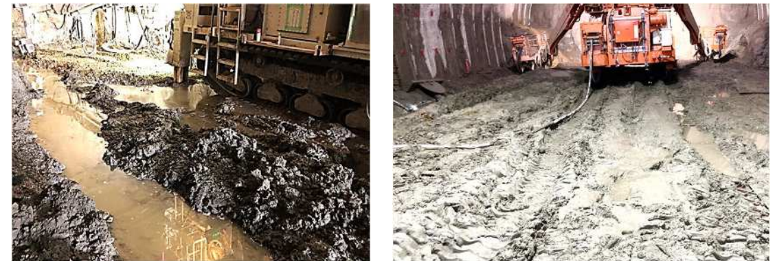
作業床面の泥濘化状況
