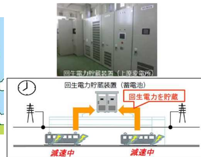
回生電力貯蔵装置(蓄電池)とその仕組み 小田急電鉄 (出典)国土交通省 鉄道分野におけるカーボンニュートラル加速化検討会 (令和5(2023)年5月)
