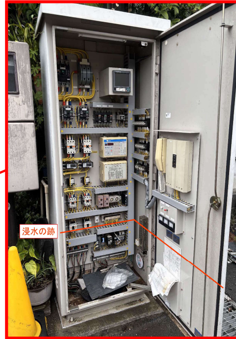
制御盤内部の状況
