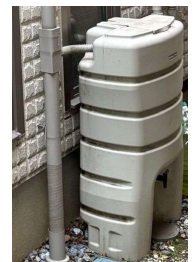
雨水貯留タンク
