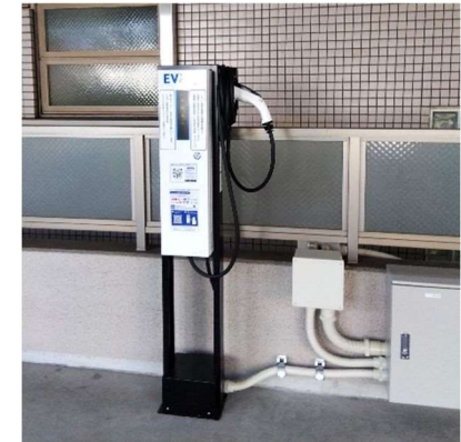
公共施設のEV用充電設備
